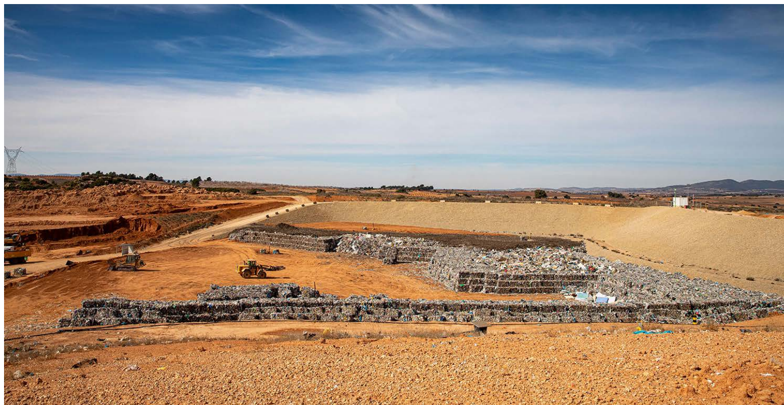
Instalación de eliminación para los rechazos de valorización, Caudete de las Fuentes, València.
